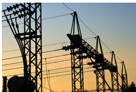
Transformatorstation i Birkerød
