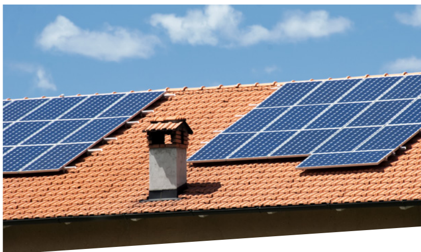
Solceller installeret på tag.
